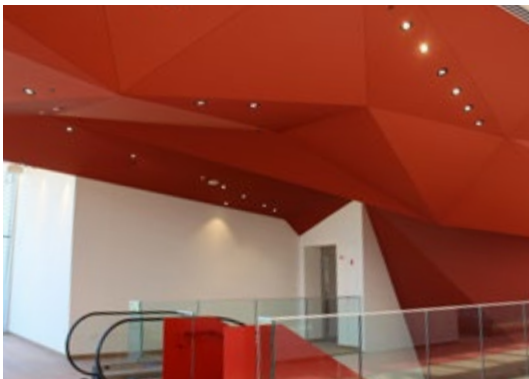
Shopping Mall « Globus Max » - ISRAEL Plafond acoustique couleur effet 3D Installation : Art Cover
